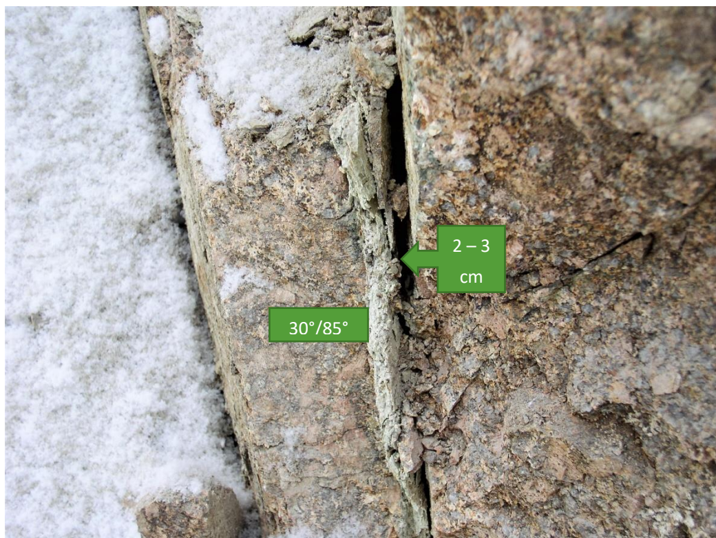
Puklina 2 – 3 cm široká vyplněná bělošedým, nazelenalým jílem (mylonit)
