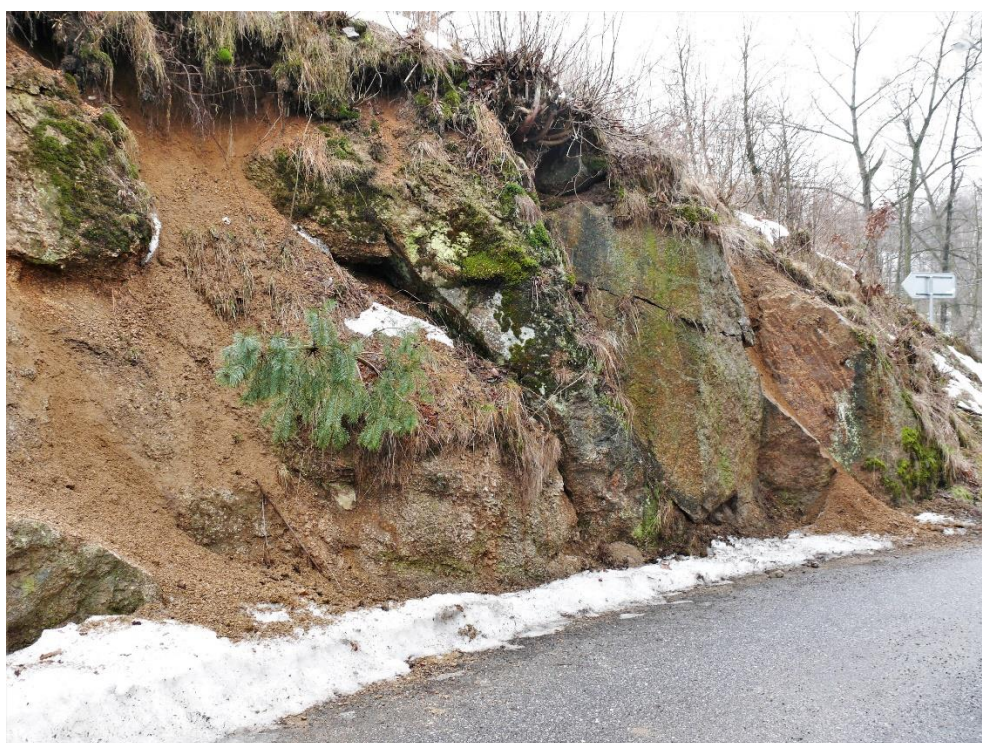
Pohled na stejný úsek po zimních sesuvech
