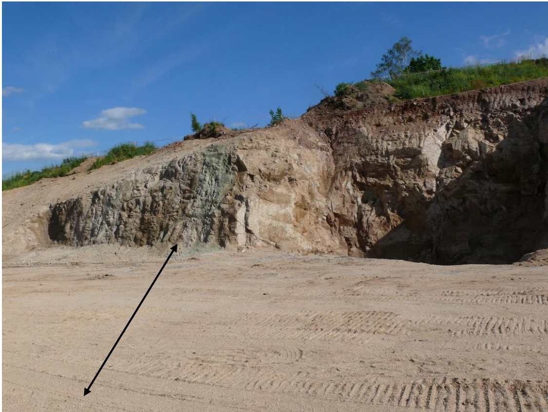
Na okraji jámy pro pilíř mostu cca 10 m mocné pásmo výrazného podrcení
