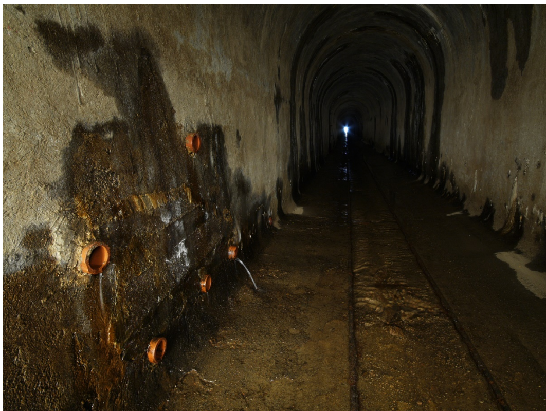
Obrázek 10.5. Drenáž z geologické poruchy (zlomu?) v loučenském tunelu.
