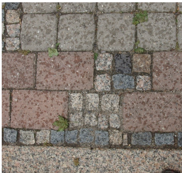
Obr. 11.10. Poškozené betonové dlaždice nahrazené trvalejšími kamennými (Horní náměstí).
