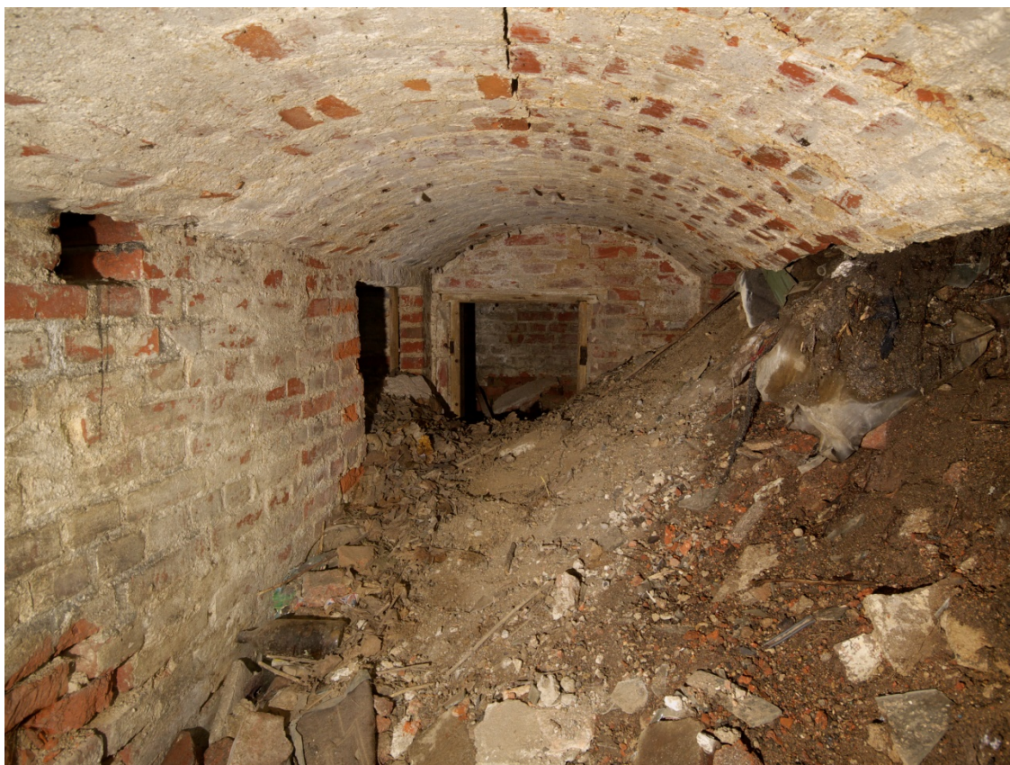
Obr. 10.17. Po destrukci podélné stěny zasypaný kryt v Janovské ulici (Pk58).
