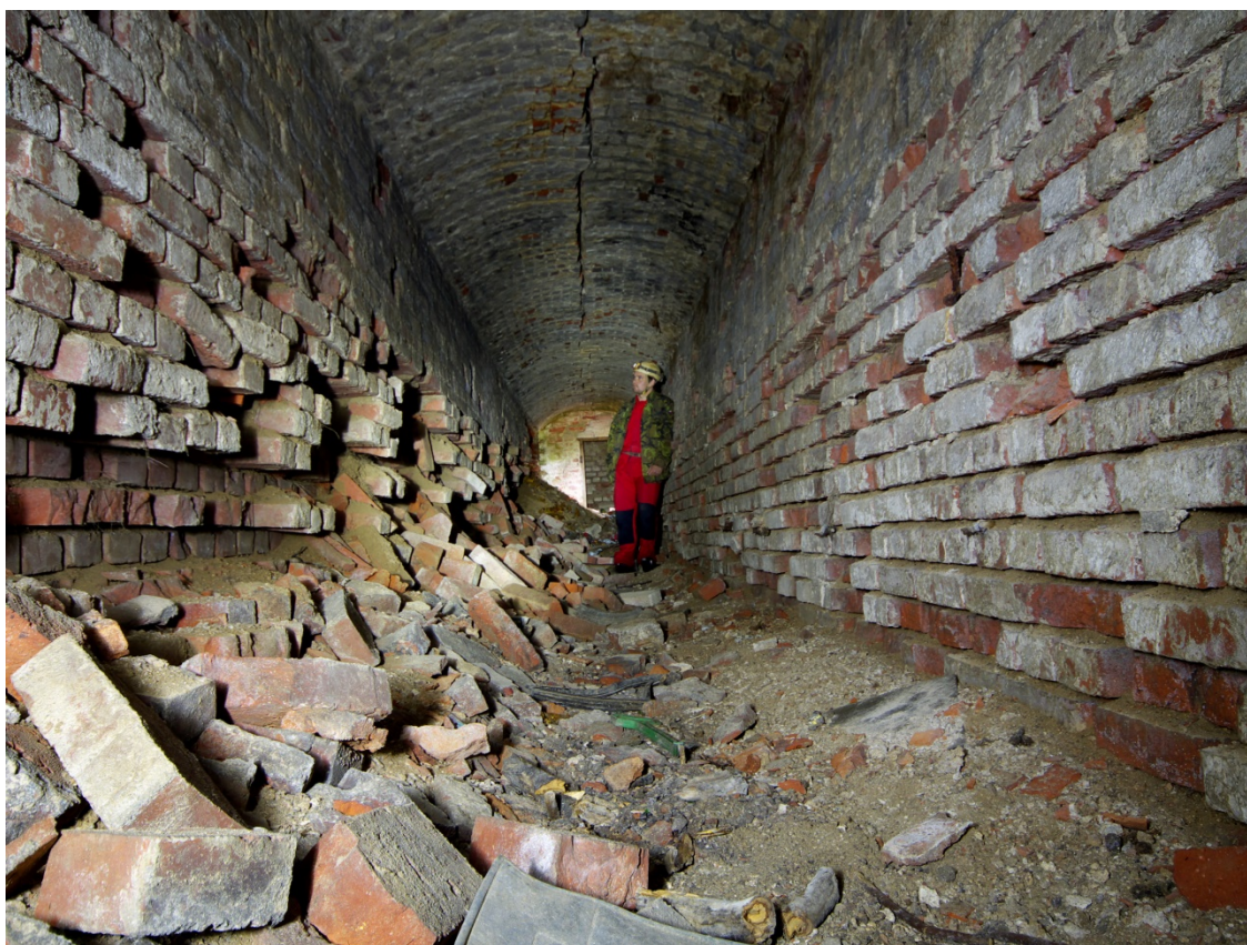
Obr. 10.18. Samovolná destrukce podélné stěny v zasypaném krytu v Janovské ulici (Pk58).
