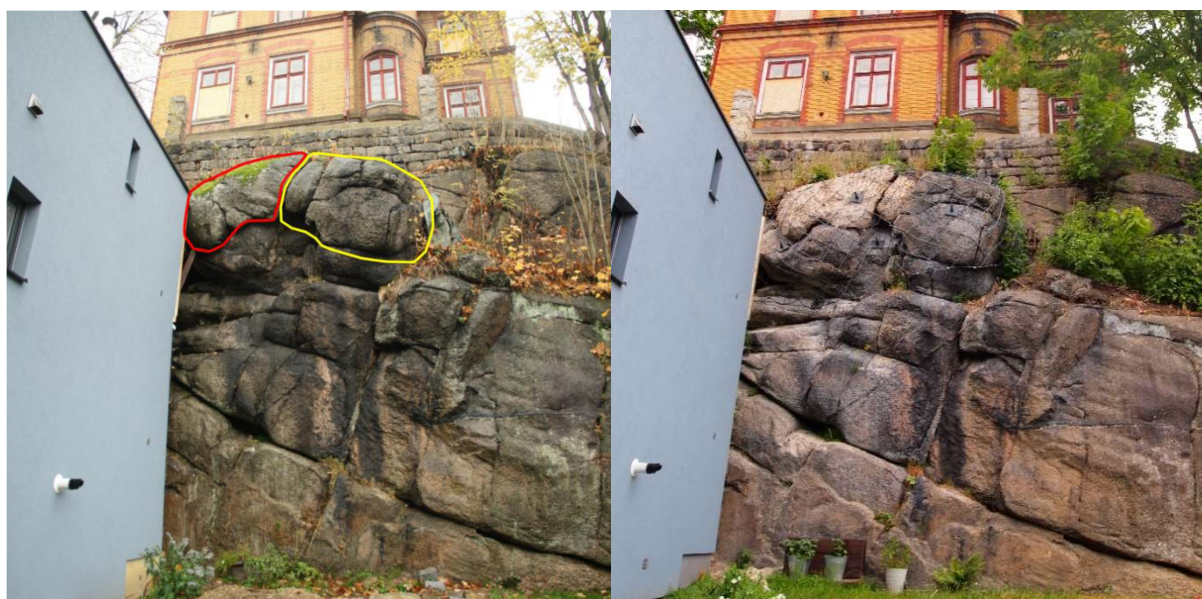
Obr. 8.12a, b) Vlevo: příklad skalních bloků s potenciálem projevu svahového pohybu (barevné polygony) ohrožující budovu č. p. 2416/16a. (foto J. Malík, ČGS, 24. října 2017). Vpravo: stabilizace rizikových bloků prostřednictvím kotvené ocelové sítě. Foto M. Aue, ČGS, 10. července 2019).
