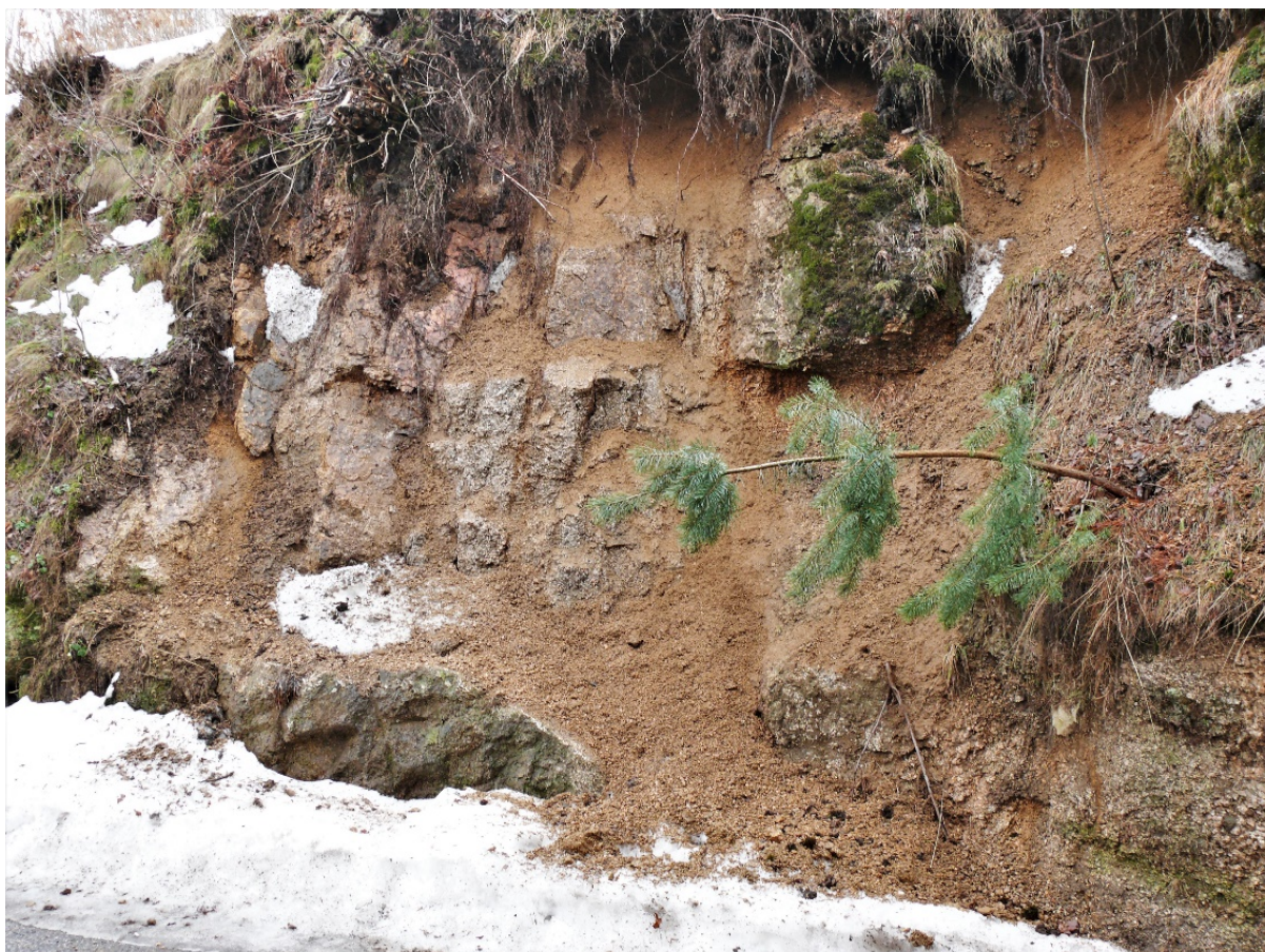
Obr. 9.10 Nepravidelné zvětrávání granitu v zářezu v důsledku tektonického porušení (foto Vladimír Bělohradský, 2. února 2010, viz příloha 7).
