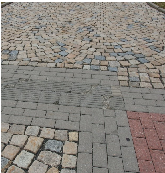
Obr. 11.9. Nevhodná kombinace kamenných a betonových dlaždic (autobusové nádraží).
