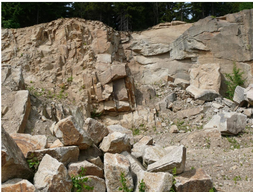
Přechod mezi postiženou západní stěnou a severní masivnější
