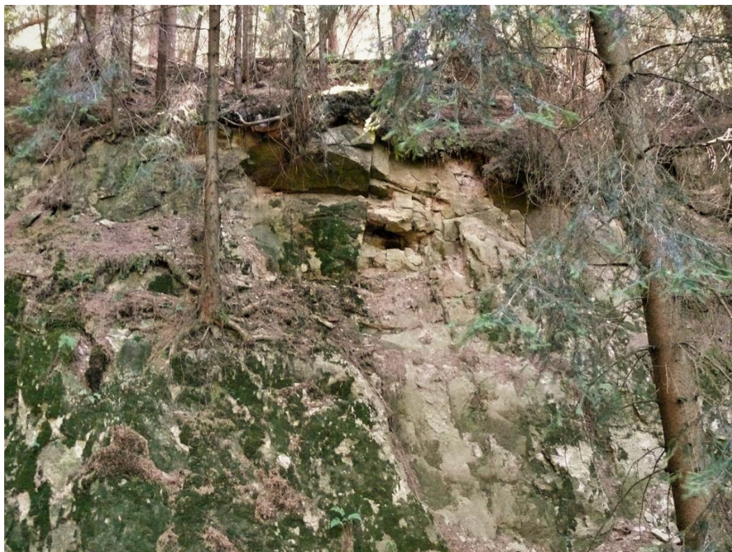
Příčné porušení stěny
