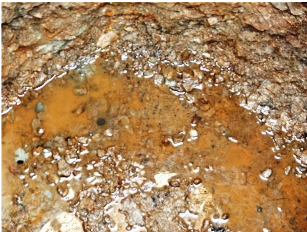
Pevnější rozpukaná okatá rula narušená technickými pracemi se hrubě destičkovitě až kostkovitě rozpadá.
