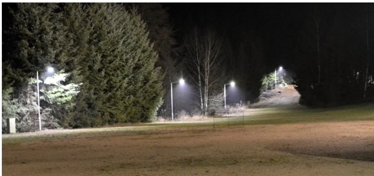
Zrekonstruované osvětlení na Kolečku v Brízkách, foto Jiří Endler
