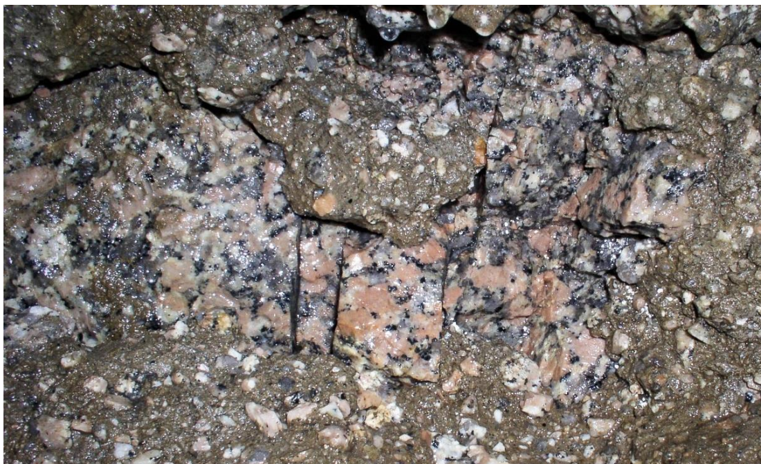
Drobná vypadlá část betonového ostění, 140 m před výstupem z tunelu. Na 10 cm 3x puklina se sklonem ve směru 160°/85°; (výsledek střelných prací, nebo přirozeného rozpukání horniny?)
