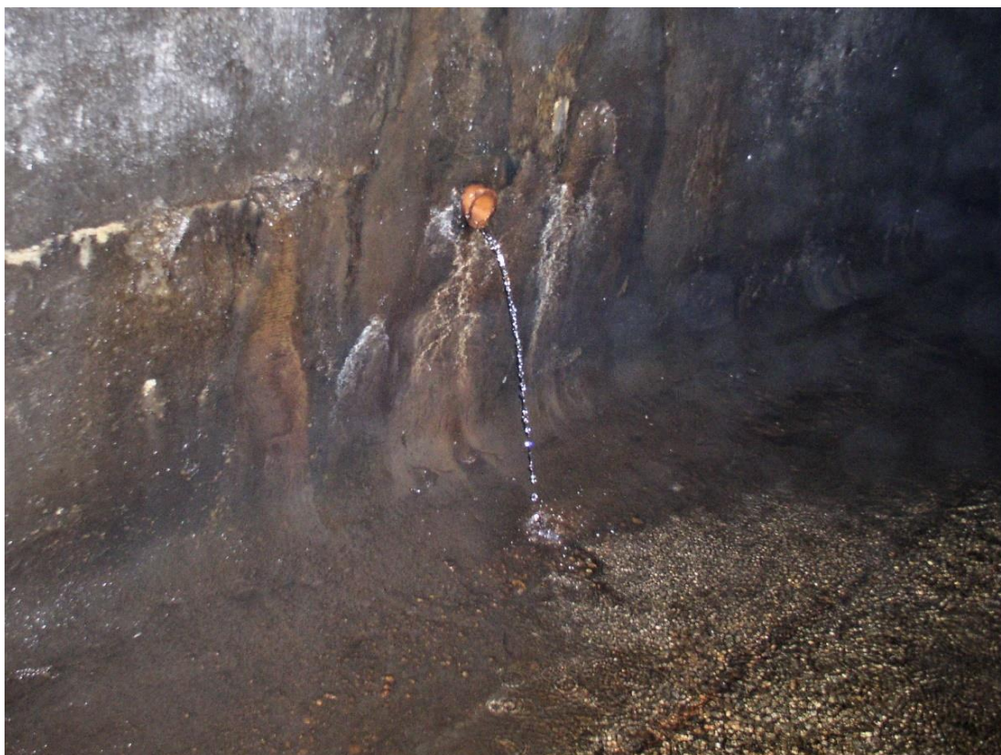
Výtok puklinové vody ze stěny tunelu cca 350 m od vyústění tunelu. Výtok okolo 0,2 l/sec. V počvě jsou zachovány původní koleje.
